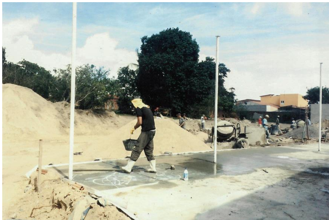
Obra de ampliação de sala de aulas e laboratórios ainda em execução – Novembro 2019
